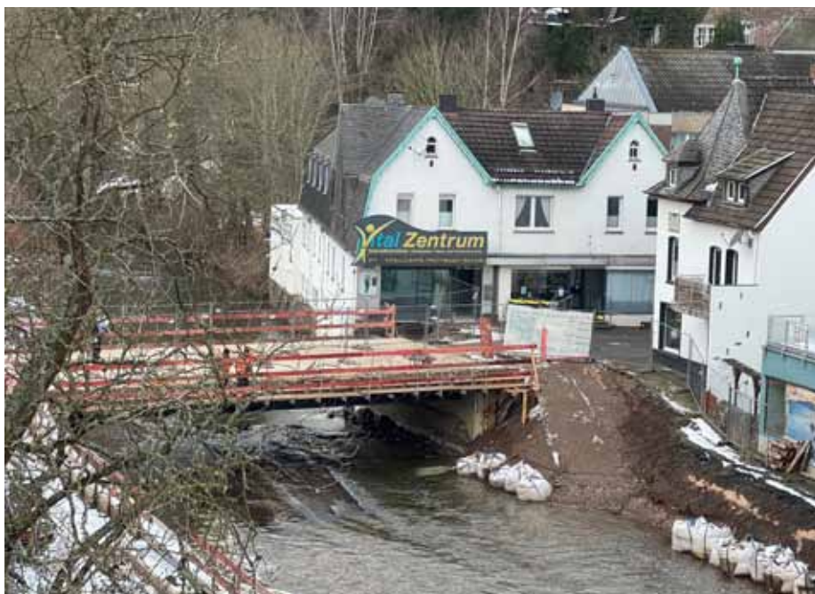
Ein Meilenstein wurde im November 2024 erreicht: Die Verbundfertigteilträger der Brücke Am Markt wurden nach sieben Monaten Bauzeit versetzt und anschließend betoniert. (© Stadt Schleiden / Kerstin Wielspütz)
